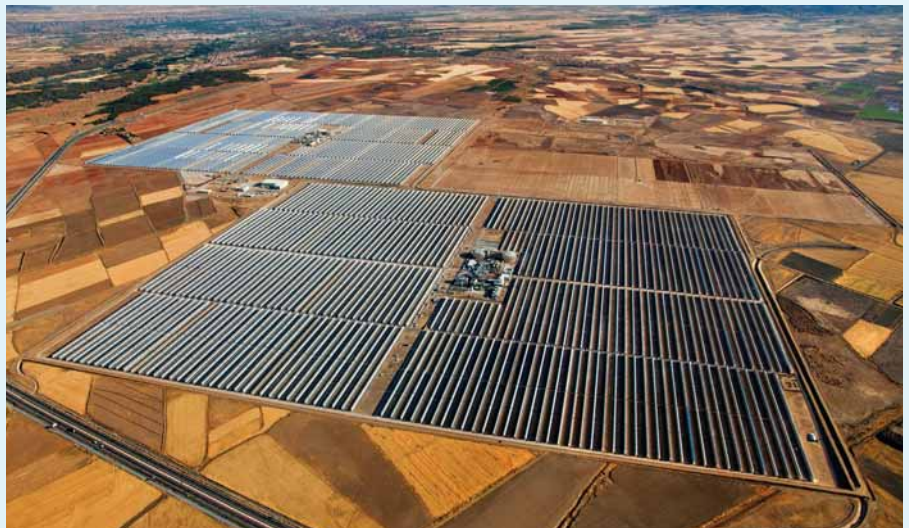
Parabolrinnenkraftwerke Andasol 1 & 2 (je 50 MW an Gesamtleistung und 7 Stunden Energiespeicher) in der Nähe von Guadix in Andalusien Foto: Flagsol
