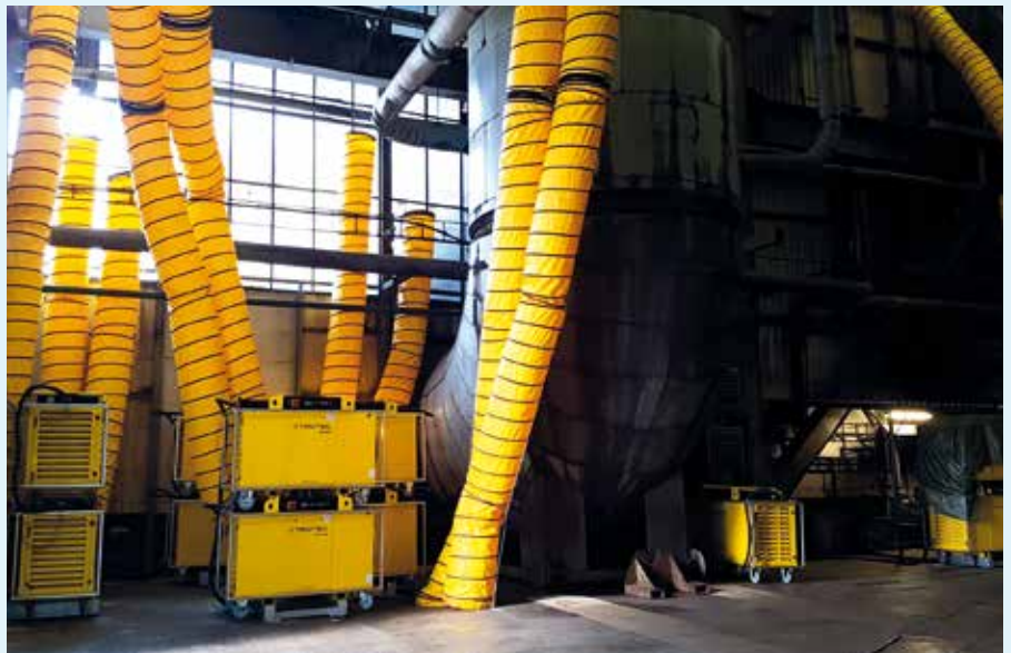
Um auch bei Außentemperaturen von bis zu -18°C Frostschäden innerhalb des Kesselhauses vorzubeugen, wurden je Block insgesamt 26 Lüfter mit einer Heizleistung von jeweils 120 kW installiert; im Bild das Kesselhaus Bilder: LEAG
