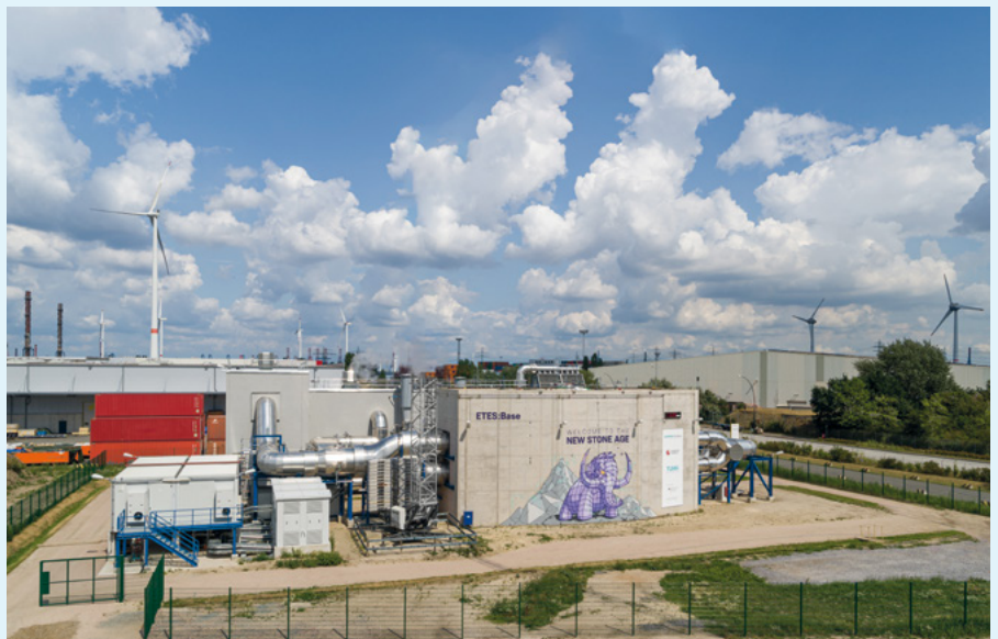
Mitten in Hamburgs Hafen wird demonstriert, wie die Energiewende den nächsten Schritt gehen kann. Ein lilafarbenes Baby-Mammut ist das Maskottchen des Elektrothermischen Energiespeichers (ETES) Bild: Siemens Gamesa
